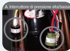
Interruttore di pressione bassa pressione
